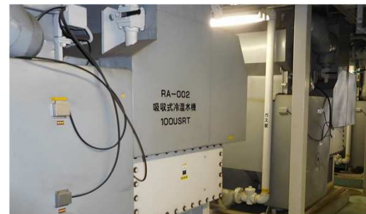
吸収式冷温水発生機
