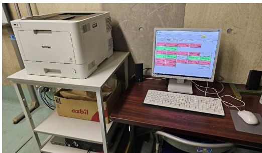
中央監視システム
