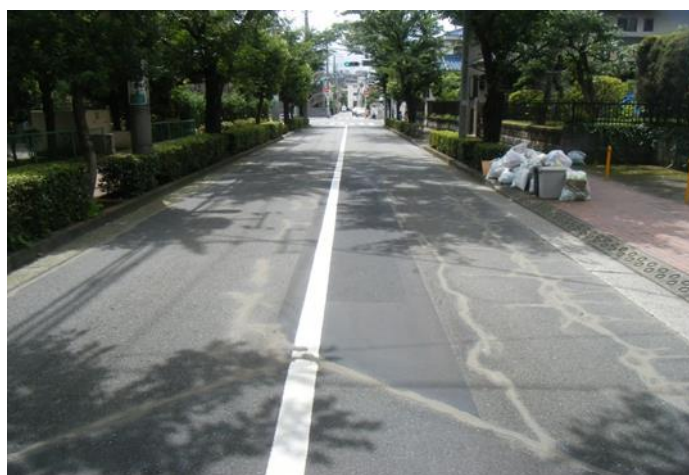
図9 クラックシール工法の例
