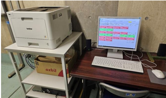
中央監視システム
