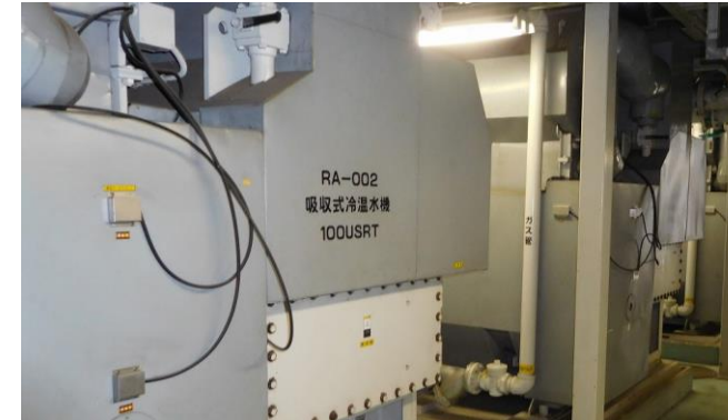
吸収式冷温水発生器
