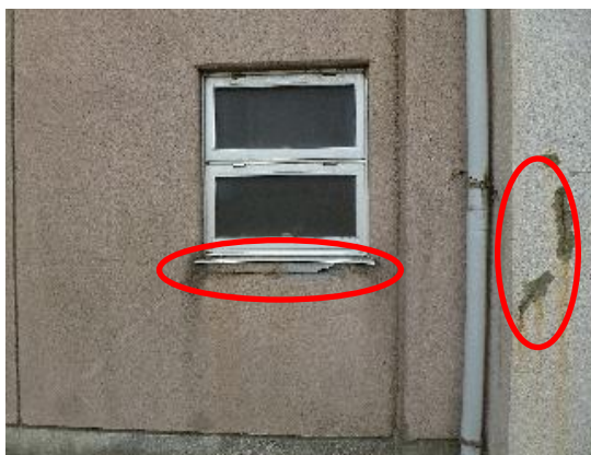
③外壁コンクリートの劣化の様子
