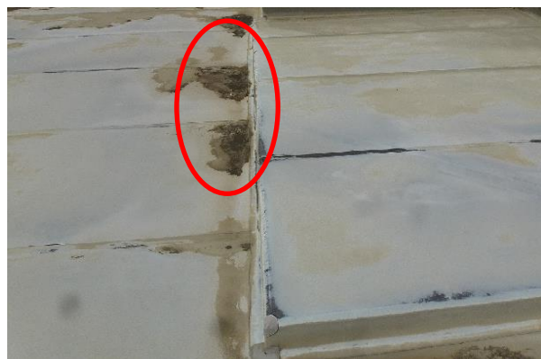
②屋上防水シートの劣化の様子
