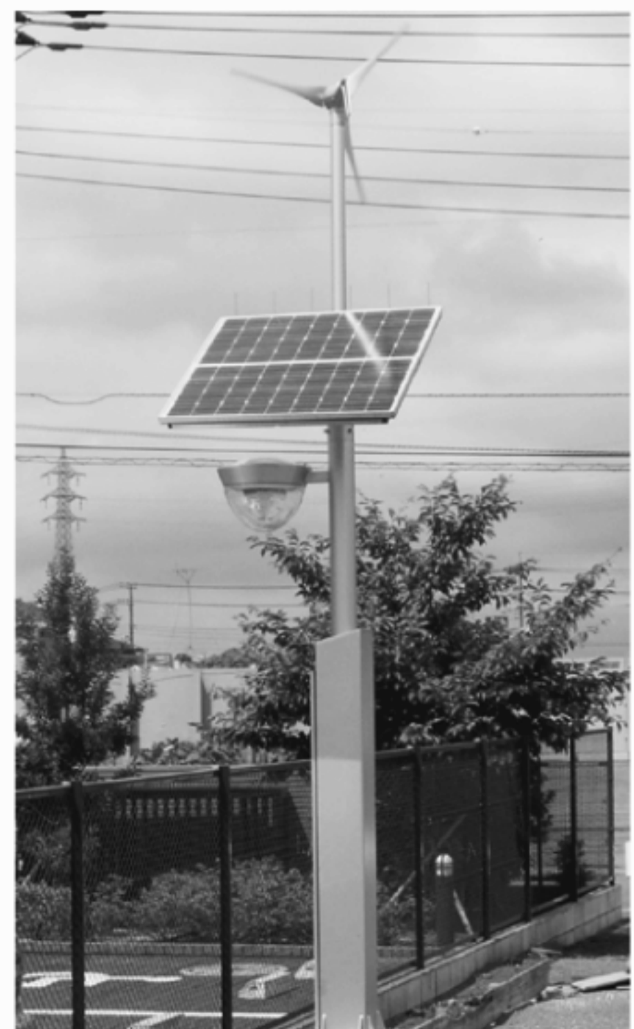
ふれあいセンター（小動）に設置された、太陽光と風力で発電する照明灯。自然エネルギーの利用を進めます
