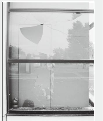
割られたガラス2
