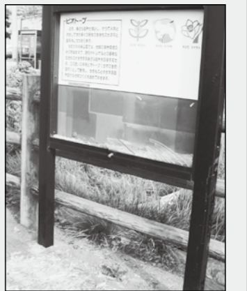
割られたガラス1
