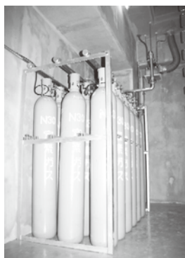
窒素ガス消火装置
