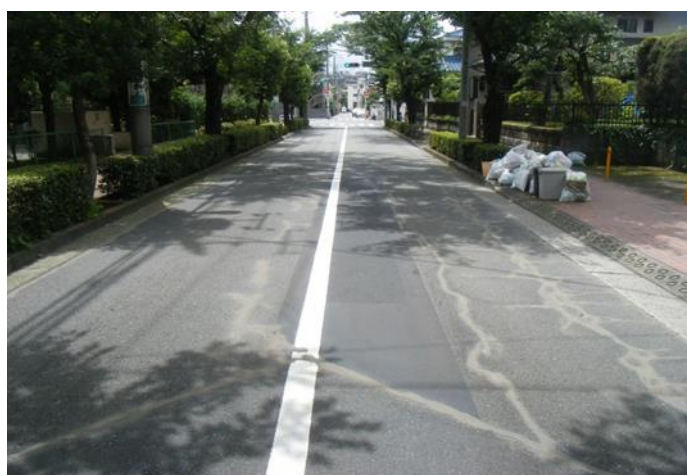
図8 クラックシール工法の例
