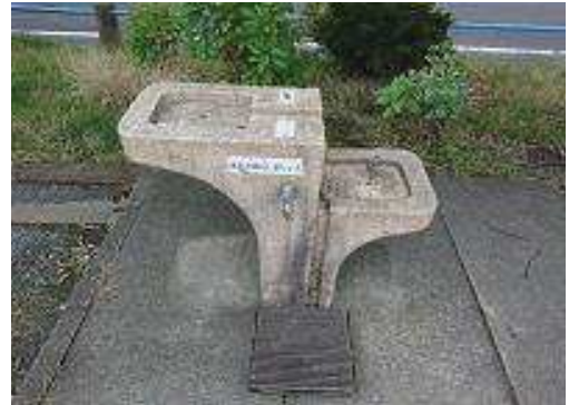
蛇口が壊れている水飲み場
