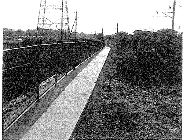
葛の除去後、ツル草等が絡まないように水路天端から、コンクリートを打設
