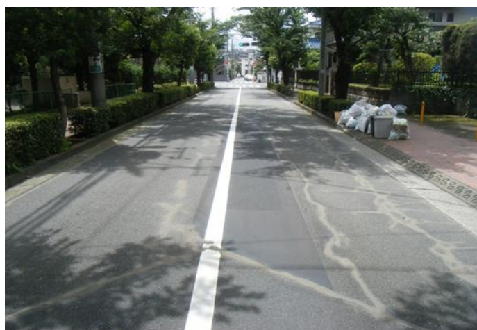
図9 クラックシール工法の例
