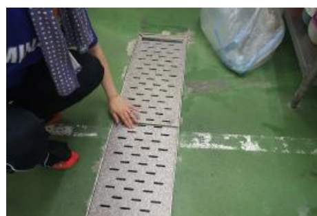
しっかりはまらない排水溝
