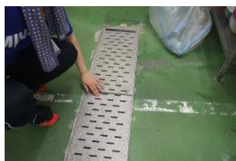
納まりの悪い排水溝
