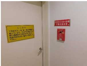
不活性ガス手動起動装置
