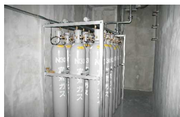
⑭消火設備
