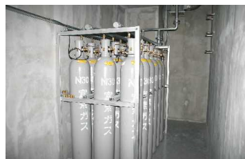
⑭消火設備
