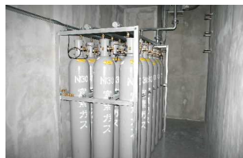
⑭消火設備
