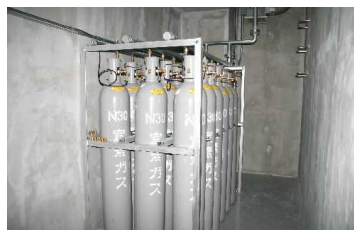
⑭消火設備
