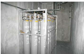
⑭消火設備
