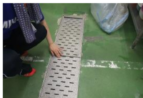
納まりの悪い排水溝
