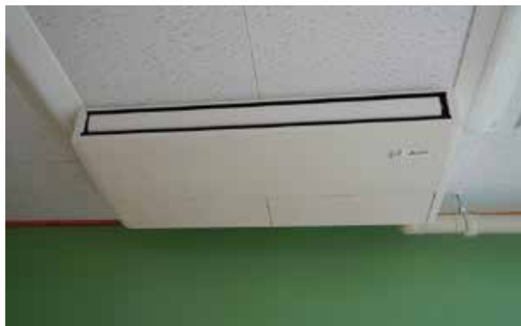
▲小谷小学校に設置されている空調機
