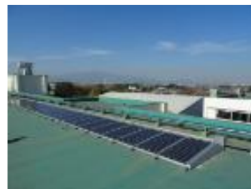
寒川小学校屋上の太陽光パネル
