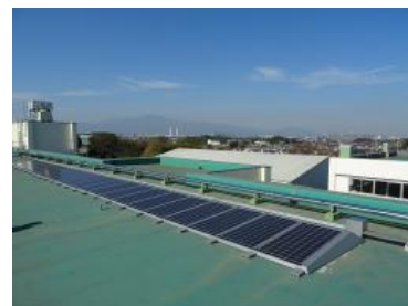
寒川小学校屋上の太陽光パネル
