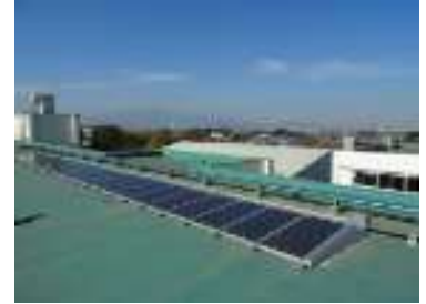
寒川小学校屋上の太陽光パネル
