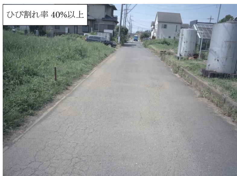
写真- 2.3 ひび割れ率による路面状態の例
