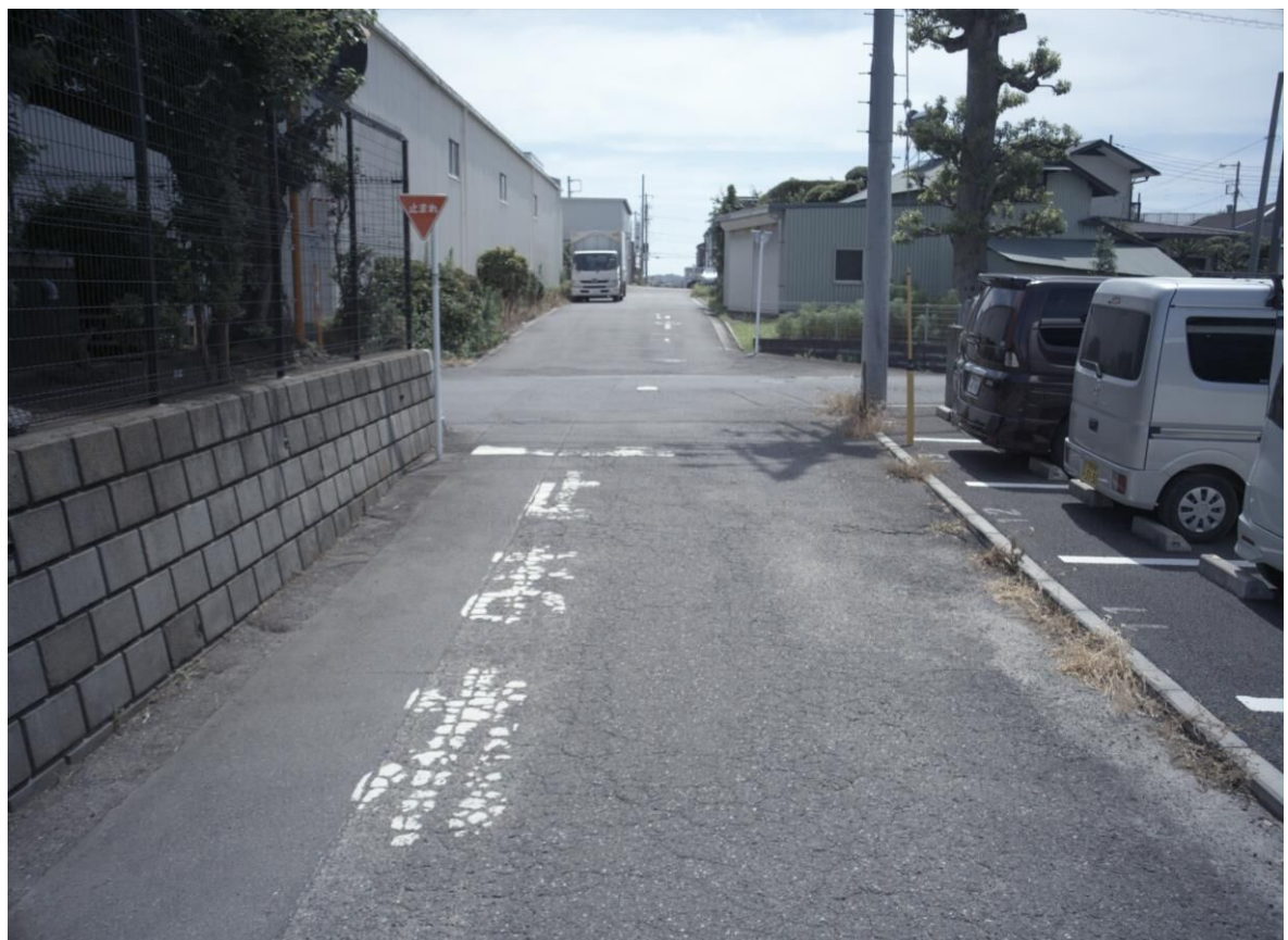
写真- 2.2 分類 D 路線におけるひび割れ率 40%の例
