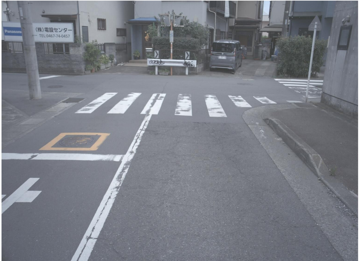
写真- 2.1 分類 C 路線におけるひび割れ率 35%の例
