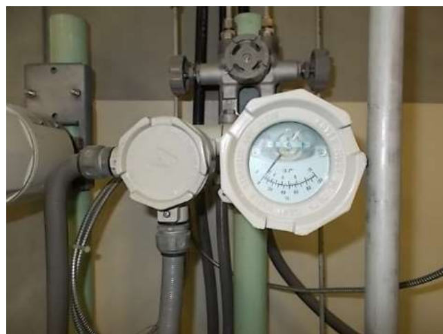
加圧曝気槽供給空気量発信器
