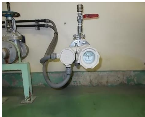
浄化槽汚泥中継槽水位計
