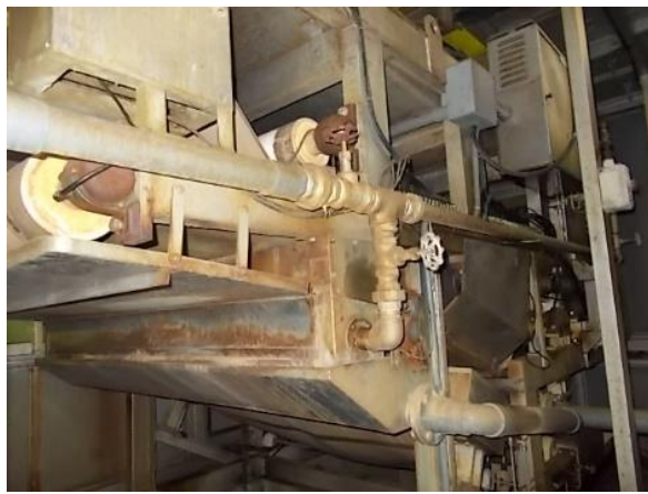
汚泥脱水機内部
