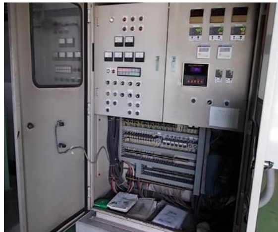
脱臭装置制御盤
