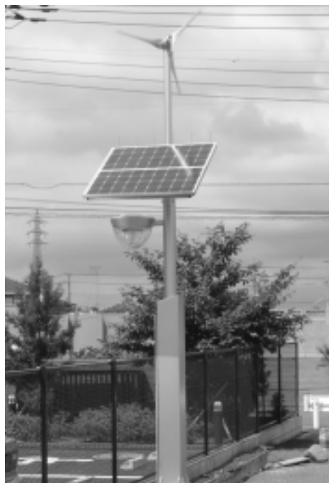
ハイブリッド(太陽光・風力)発電照明灯
