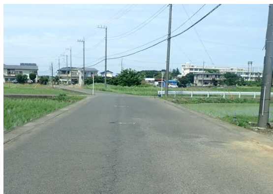
道路の老朽化
